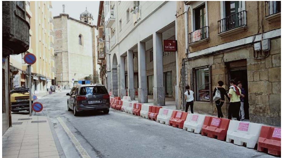
Calbeton kalea astelehenean zabaldu zuten ibilgailuentzat eta egindako lanei esker laster koexistenzia-gune berria egongo da prest.
